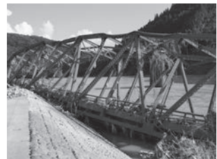
令和2年7月豪雨の災害調査
