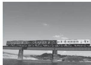
流失した第4橋梁を走る列車
